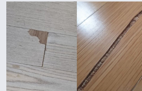
충격에 파손 및 갈라짐 현상
